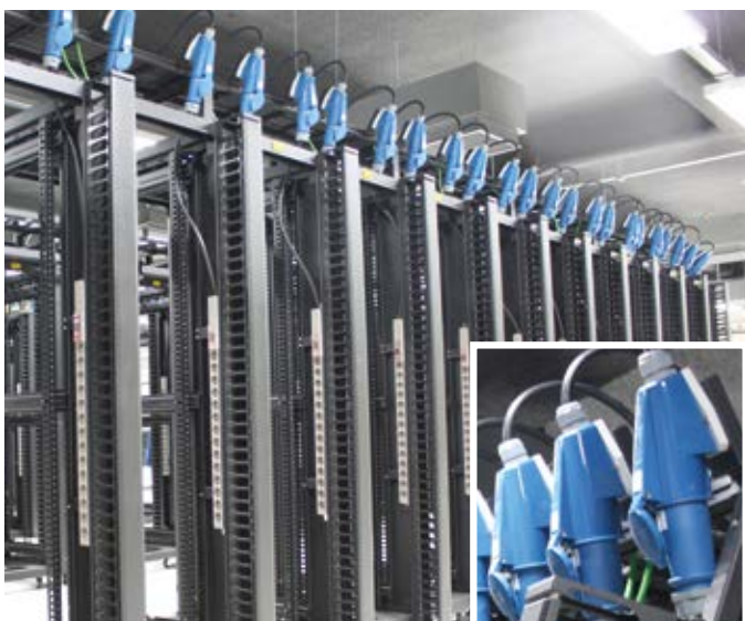
Internet Data Center , Corea del Sud
